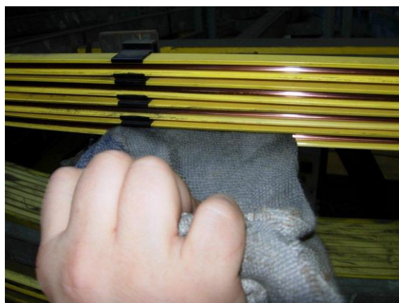
图 9:清除滑触线支架上的污垢
